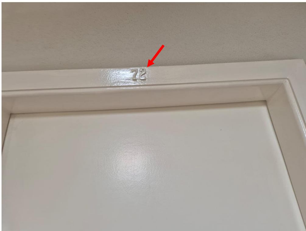
FOTO N.º 06- Aspecto da placa identificativa do apartamento de n.º 72.
